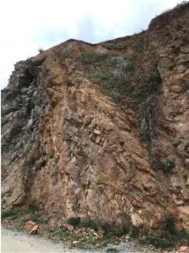
Observation BSL13 = Faille marquant la limite en le gisement sain au sud et le couloir de faille altéré
